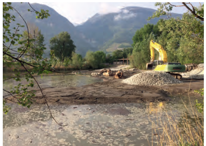
Figure 6 : Mise en place des bancs de graviers et des souches [04.05.2018] Abbildung 6: Einbringen der Kiesbänke und der Wurzelstöcke [04.05.2018]
