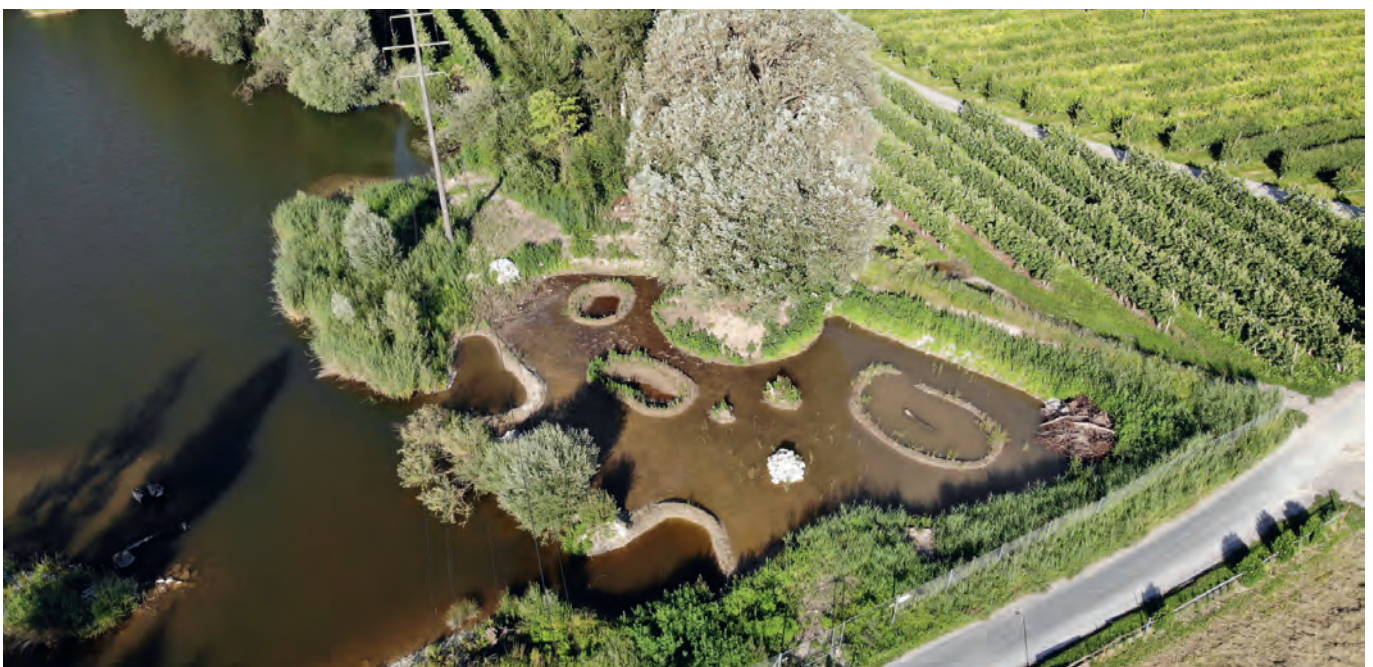
Figure 10: Phase 3, abgeschlossene Arbeiten am Südufer mit Schaffung von Untiefen, Wasserflächen, Geröllhalden und Totholzhaufen ausserhalb des Hochwassers, Drohnenansicht bei Hochwasser 05.07.2022
