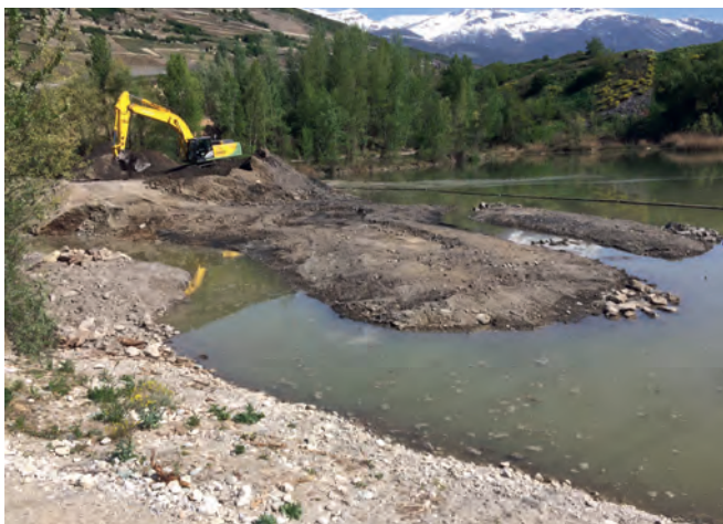
Figure 3 : Travaux de modelage des rives et des îlots [25.04.2018] Abbildung 3: Arbeiten zur Modellierung der Ufer und der Inselchen [25.04.2018]
